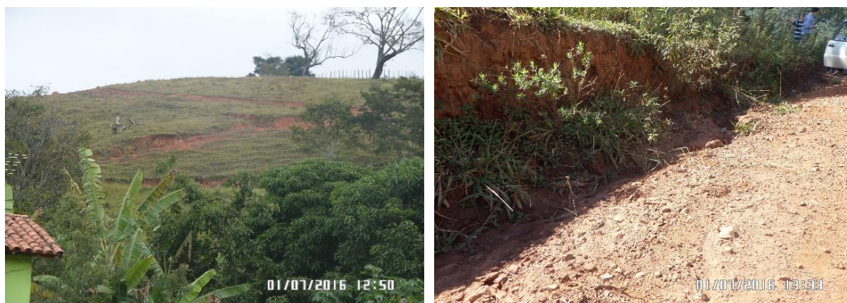
Figura 4.3 – Atividades erosivas e estrada vicinal mal conservada
