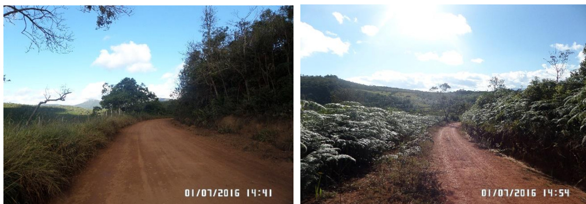
Figura 4.4 – Trechos de estradas vicinais em mau estado de conservação
